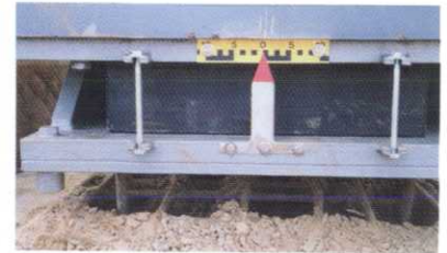
Zur Vermeidung von Zwängungen werden die Brücken auf beweglichen Elastomer- blöcken gelagert.
